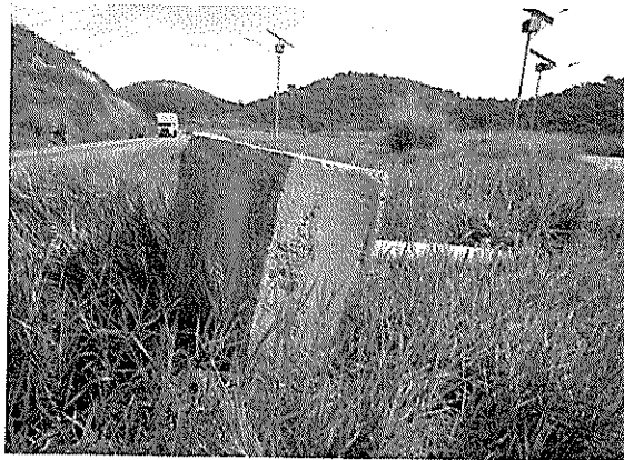
Bloco tombado que não apresentava indícios de ter sido executado sobre estaca
