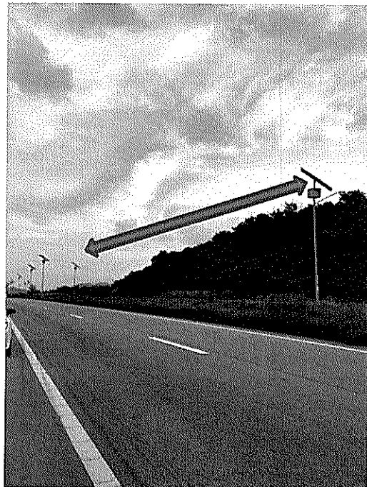
Trechos com diversos postes ausentes
