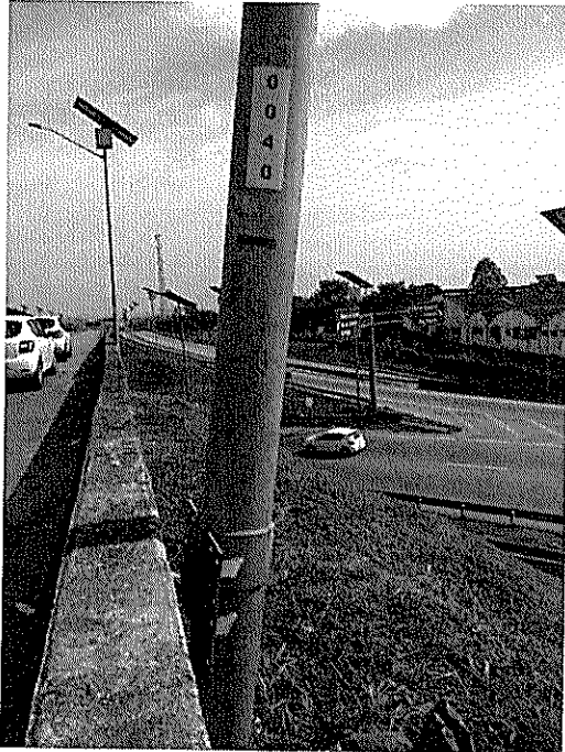
Postes não fixados
